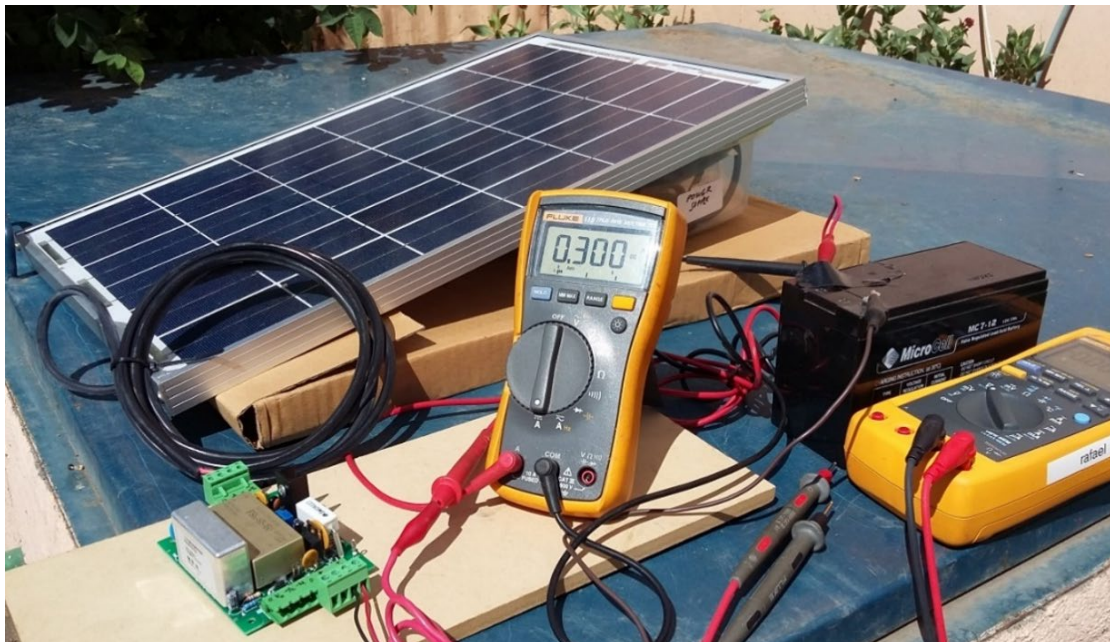
Figura 7: Vista de ensayo con panel solar del módulo UPS+PWRsv1 y mediciones de corriente (0.3 A) y tensión.
